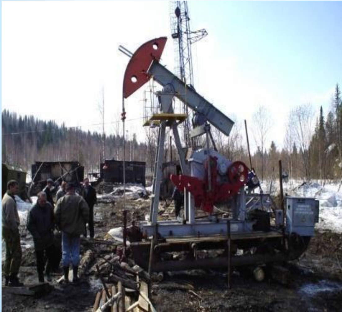
Станок-качалка на скв. 10380 бис
