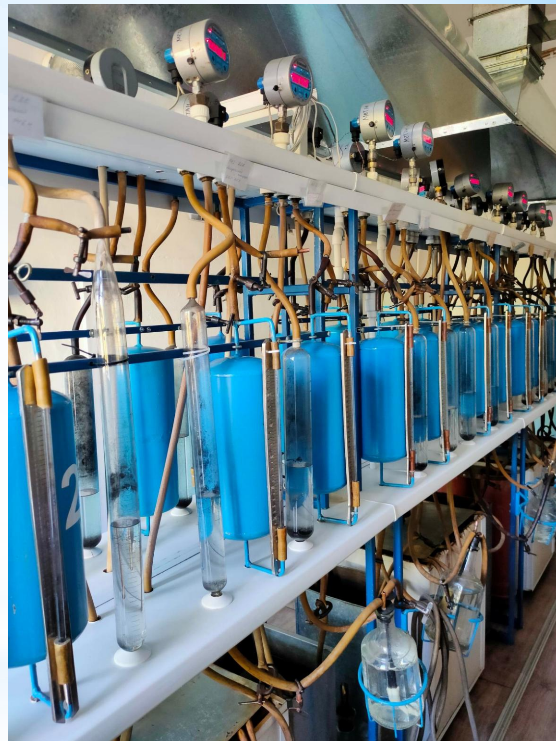
Дегазационная стационарная установка
