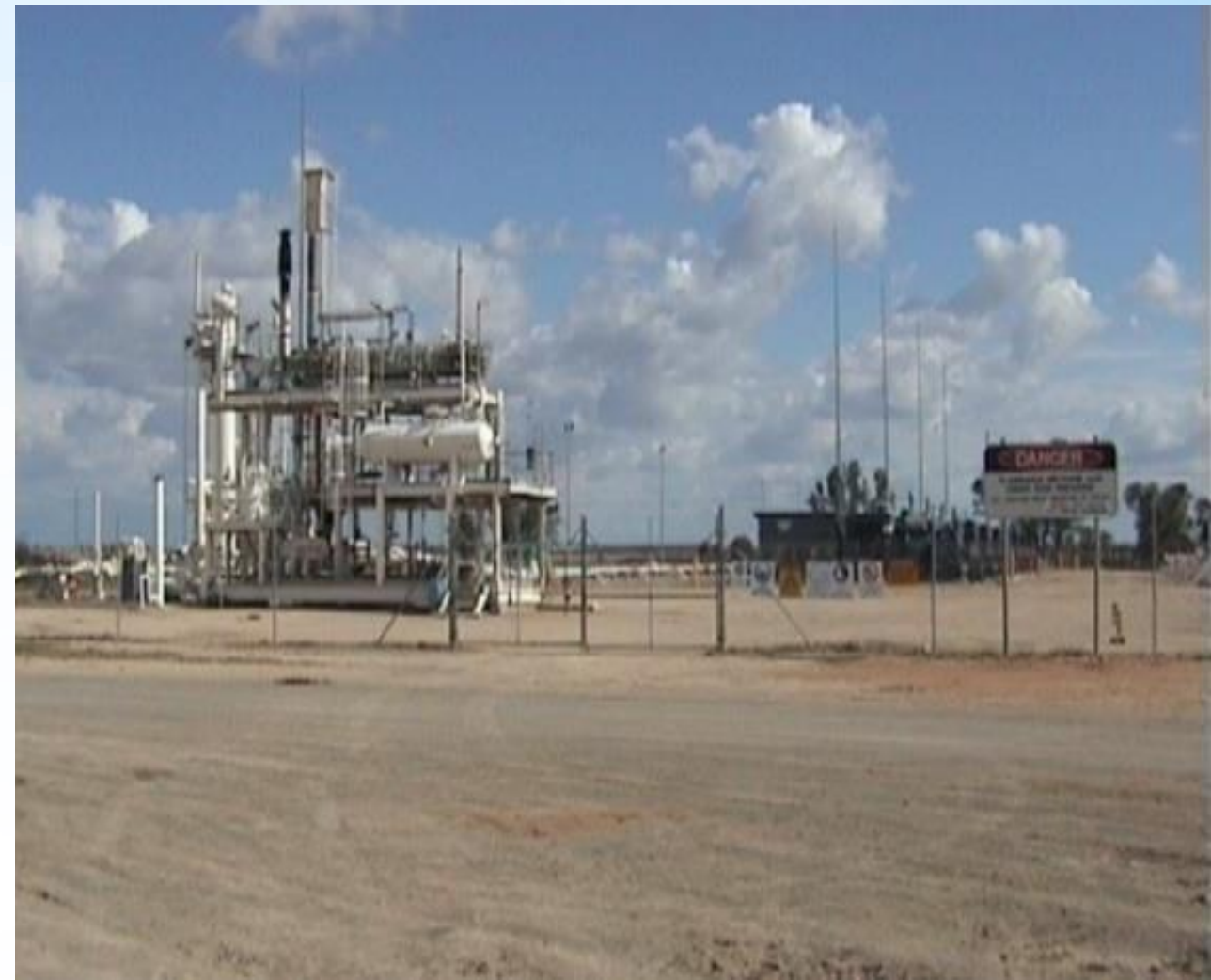
Станция подготовки газа (Разрез Moura)
