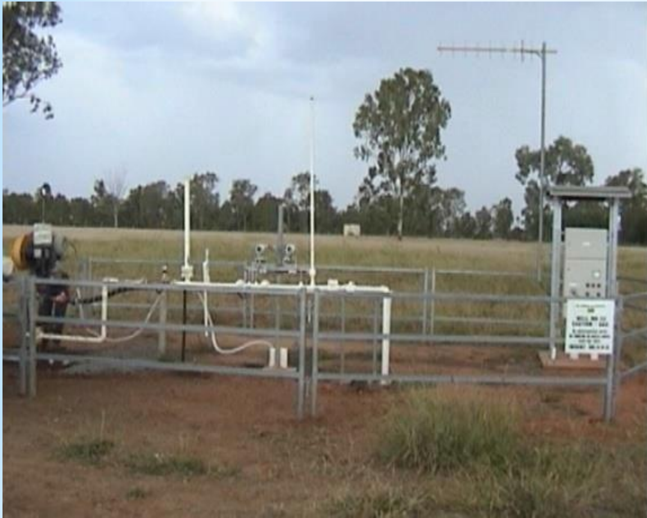
Размещение оборудования на скважине (Oil company of Australia)
